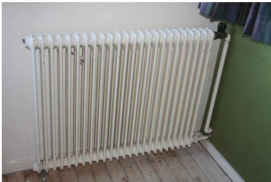
Voorbeeld oude radiator
